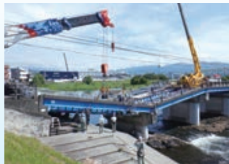
V字形に崩壊した黄瀬川大橋
